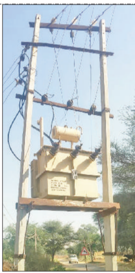
सिरसा। बिना कट हैंडल लगाया गया बिजली ट्रांसफॉर्मर।
